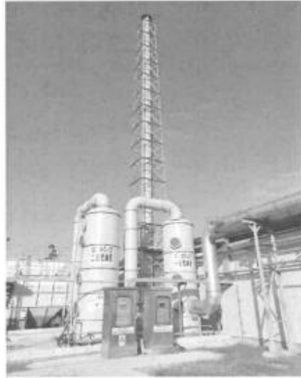
危废仓库及污水站废气处理设施
