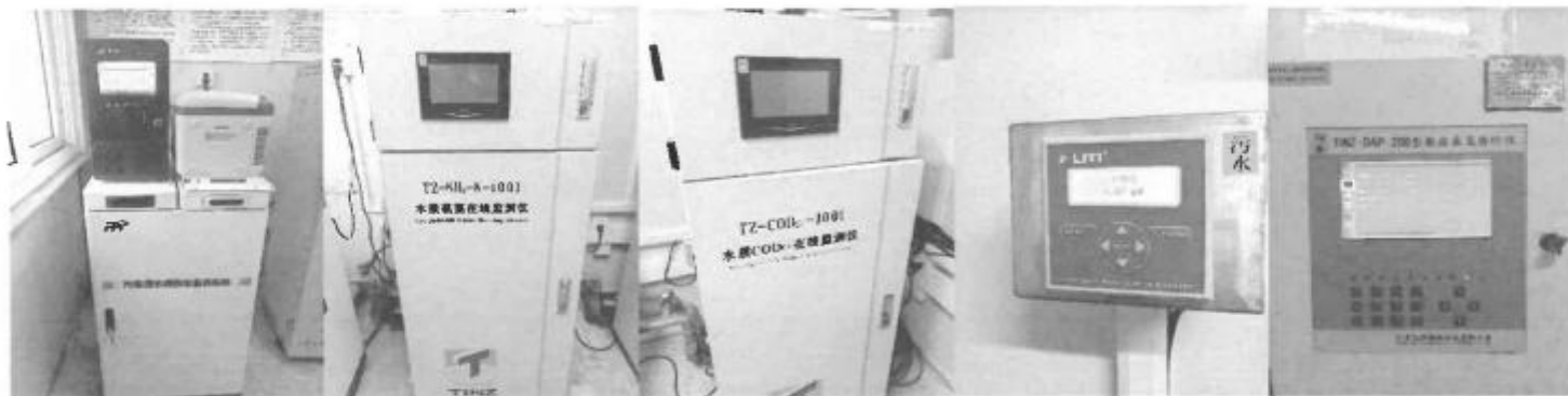
废水在线监测设备及数据传输设备
