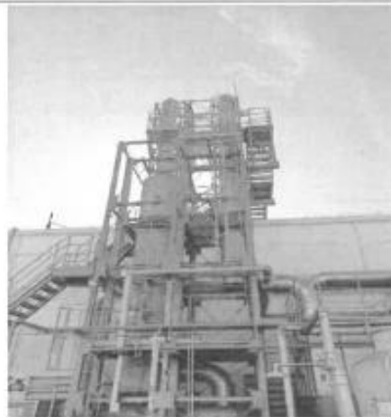
环氧树脂生产车间水喷淋塔及集尘机
