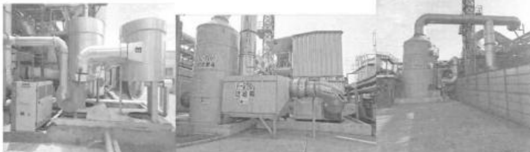
酚醛树脂生产车间有机废气处理设施（低温冷凝+RTO+两级碱喷淋）
