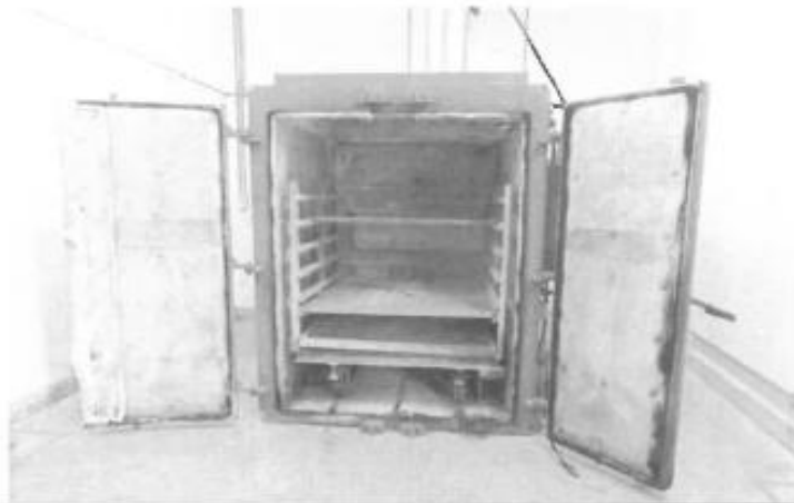
多层功能复合膜生产车间净化炉
