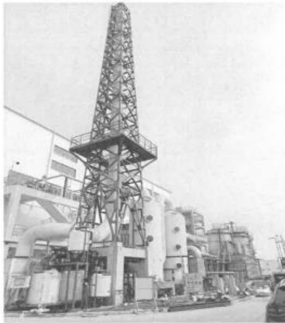
酚醛树脂特种功能复合材料生产车间有机废气处理设施
