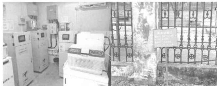
在线监测设备及排口标识牌
