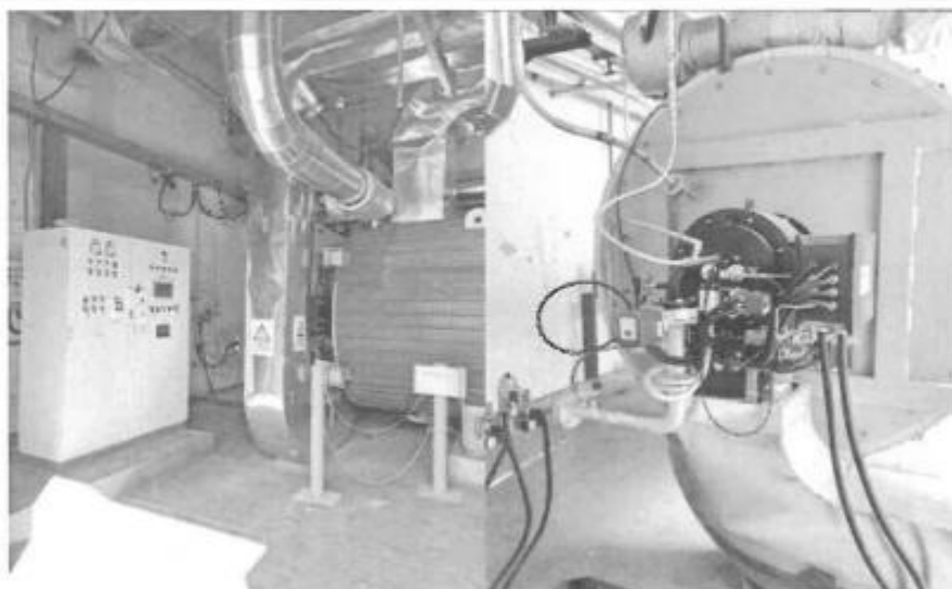
酚醛树脂生产车间导热油炉（低氮燃烧）
